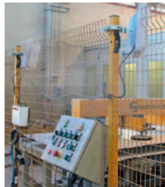
Reader e antenne Rfid nell'impianto di inizio linea produzione presso lo stabilimento di Zimella di Stone Italiana
