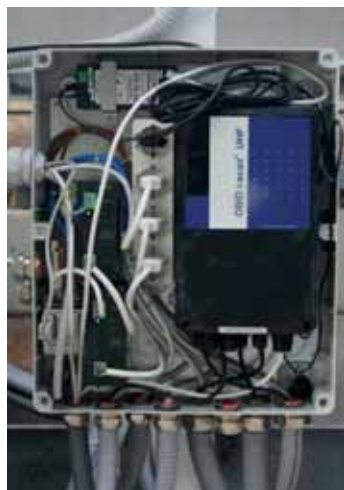
Il controller LRU2000 costituisce il 'cuore tecnologico' del sistema Rfid lungo la linea di produzione
